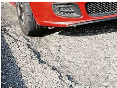
Asfalto deteriorato su una provinciale BEDOLIS
