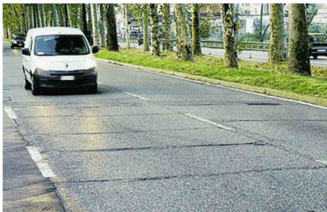
Avvallamenti dell'asfalto sulla circonvallazione delle Valli a Bergamo
