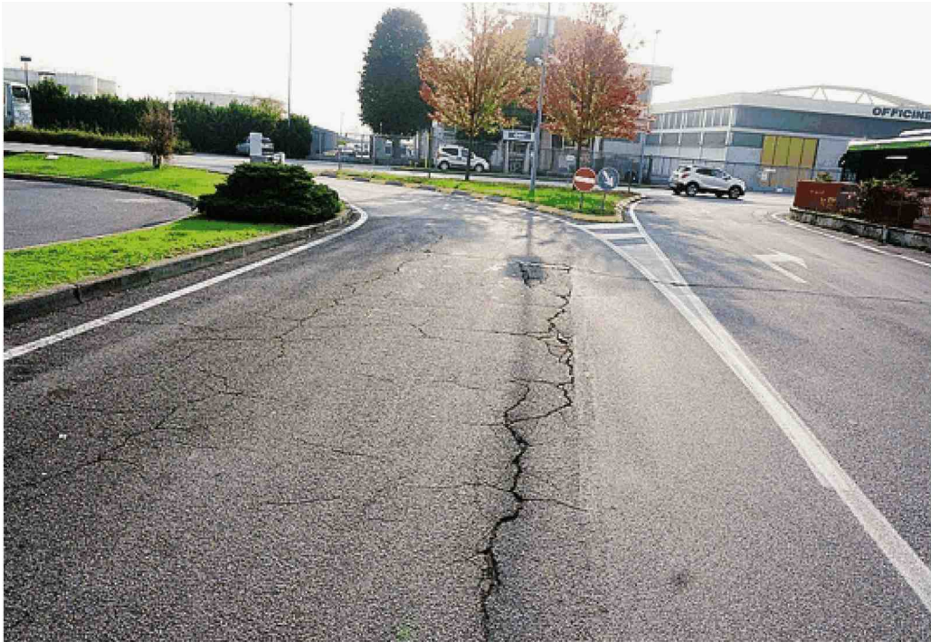
L'incrocio dell'ex statale 525 a Lallio: qui la buca è una lunga crepa nell'asfalto FOTO YURI COLLEONI
